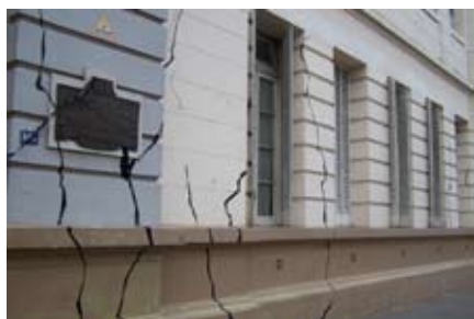
La grieta. Dante Taparelli.
